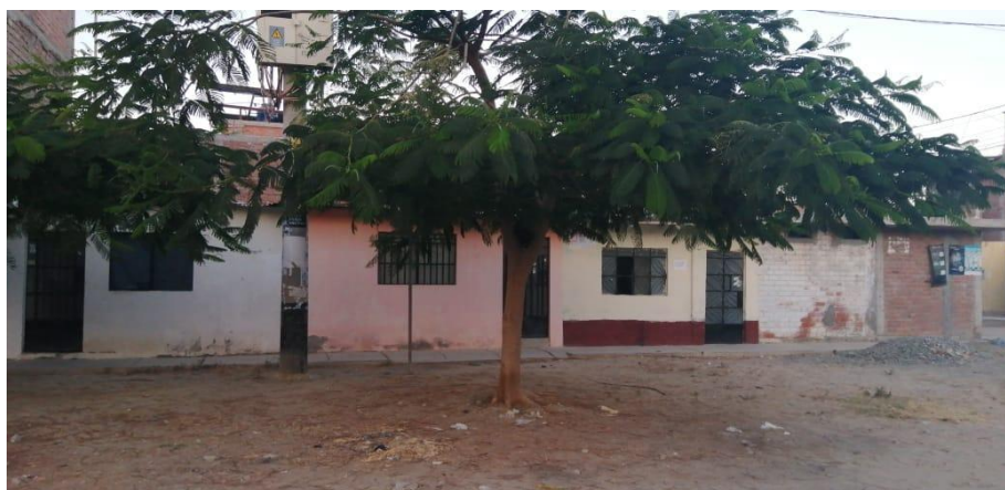
Foto N° 01: Vista frontal del muro A-E se aprecian 3 viviendas con puertas y ventanas.
